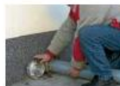
Conexión del tubo de aire al depósito en casa
